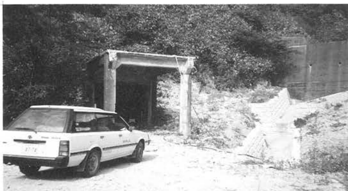
尾小屋地下測定室入口 電源設備の設置により長時間にわたるラドンと風速の同時測定が可能になった
