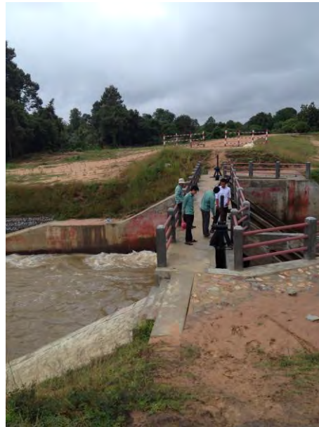
写真1. 流れを調節するスライドゲート
