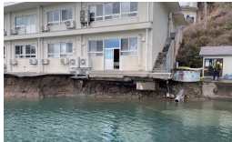
令和6年能登半島地震後の臨海実験施設の状況
